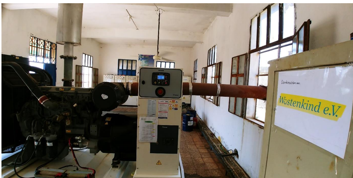
Reparierte Anlage für E-Strom für die Vertikal- und Horizontal-Pumpen der Station der Wasserversorgung in Jabal Wastani
